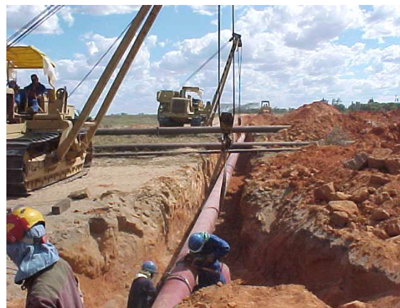
Gasoductos y oleoductos. Diseñados y construidos por empresas venezolanas
