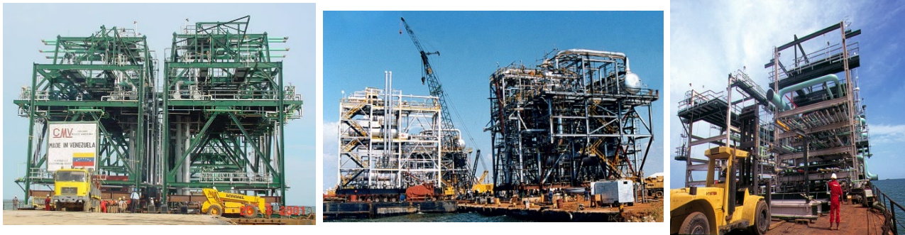
Módulos de procesos y tuberías. Hechos en Venezuela, en la Costa Oriental del Lago
