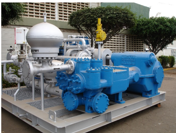
Skid de producción, Lago de Maracaibo. Diseñado, fabricado (equipos y estructura) y montado por empresas venezolanas
