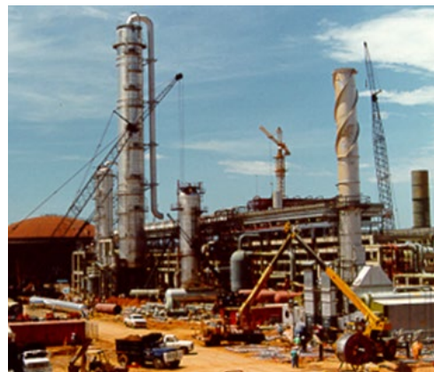
Planta de metanol. Ingeniería de detalles y construcción por empresa venezolana
