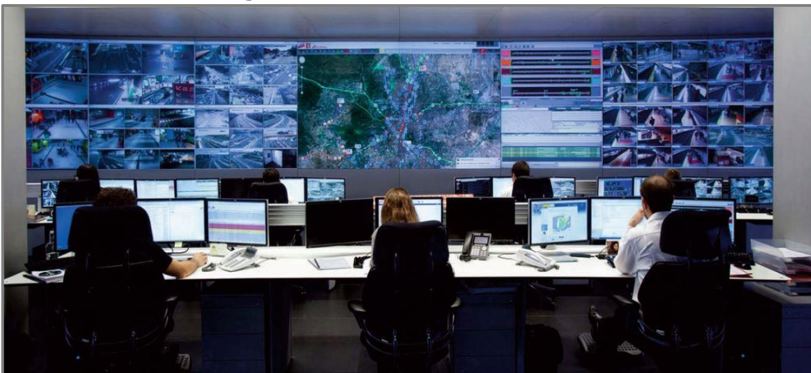
Imagen N° 20. Puesto Central de Control
